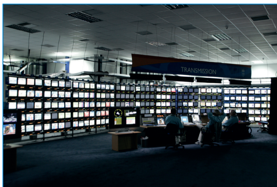
La salle des transmissions du Centre International de Radio et de Télévision.
